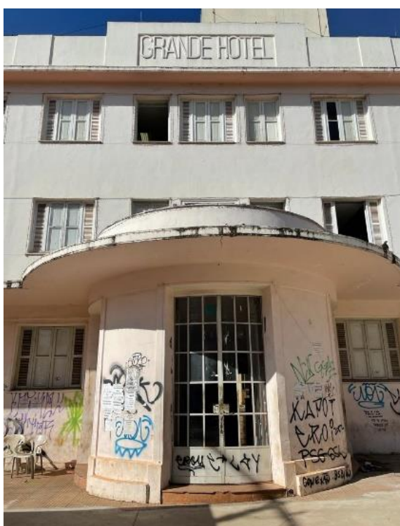
Figura 59: Detalhe de hall de entrada degradado do antigo Grande Hotel
