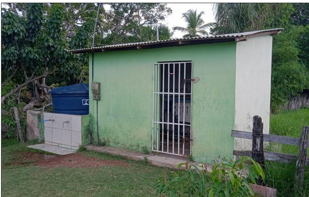
Figura 47 – Dessalinizador na zona rural do município de Arari
