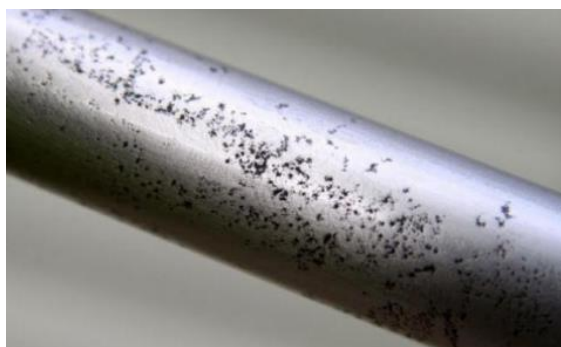
Figura 4 – Corrosão por pite em aço carbono
