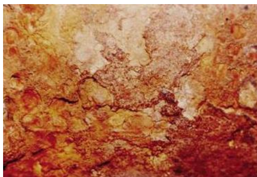
Figura 1 - Corrosão uniforme em chapa de aço carbono
