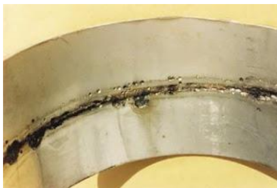
Figura 10 – Corrosão em tubulação de aço em torno de cordão de solda
