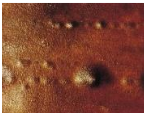
Figura 9 – Empolamento por hidrogênio em chapa de aço carbono
