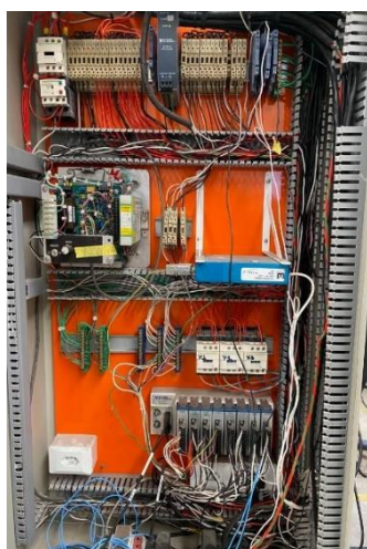
a) Quadro de Potência
