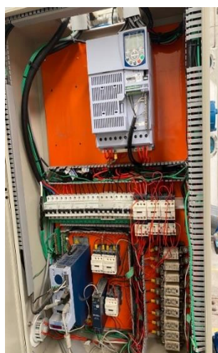
b) Quadro de Comando
