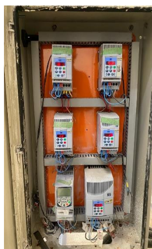
b) Quadro de Comando
